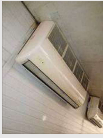
APARELHO CONDICIONADOR DE AR MARCA ELGIN MOD PHFI 60000 2 POT 60000 BTU TENSÃO 220 V | Item: 409 |
