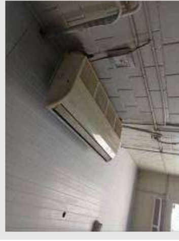
APARELHO CONDICIONADOR DE AR MARCA ELGIN MOD PHFI 60000 2 POT 60000 BTU TENSÃO 220 V | Item: 88 |
