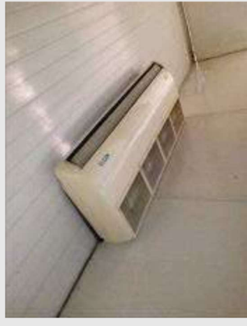
APARELHO CONDICIONADOR DE AR MARCA ELGIN MOD PHFI 60000 2 POT 60000 BTU TENSÃO 220 V | Item: 410 |
