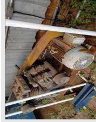
COMPRESSOR DE AR DIRETO COM MOTOR DE 25 CV | Item: 909 |
