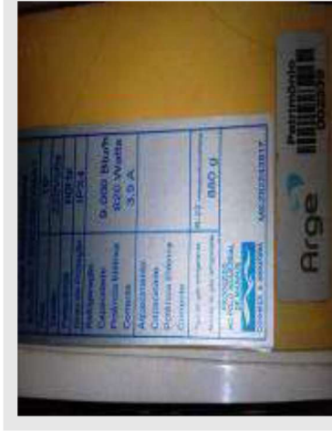
APARELHO CONDICIONADOR DE AR MARCA LG MOD TSNC092YMA1 POT 9000 BTU TENSÃO 220 V | Item: 290 |
