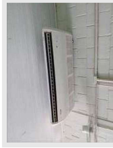
APARELHO CONDICIONADOR DE AR MARCA ELGIN MOD PHFI 60000 2 POT 60000 BTU TENSÃO 220 V | Item: 92 |
